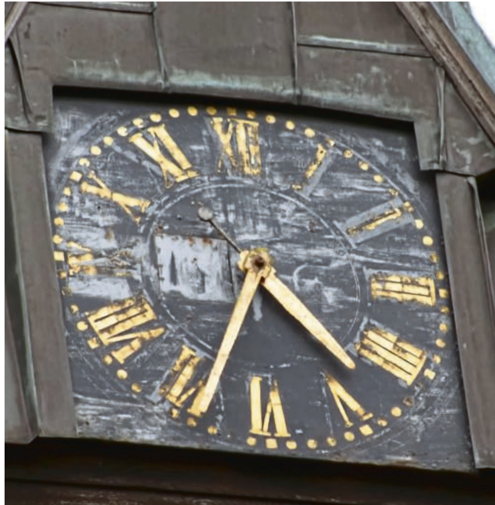
Das westliche Ziffernblatt der 1903 erbauten St. Michaeliskirche in Ehra ist stark verwittert. In diesem Jahr soll es wieder zum Strahlen gebracht werden.
