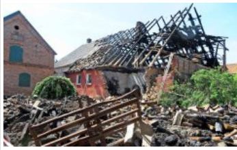
Trümmerfeld: Von dem alten Niedersachsenhaus hat das Feuer nicht viel übrig gelassen – eine Brandmauer hielt jedoch Stand, so dass persönliche Dinge der Bewohner gerettet werden konnten. Jörg Rohlfs
